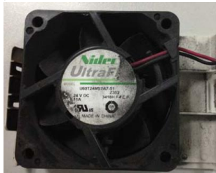
风扇上布满金属粉尘
